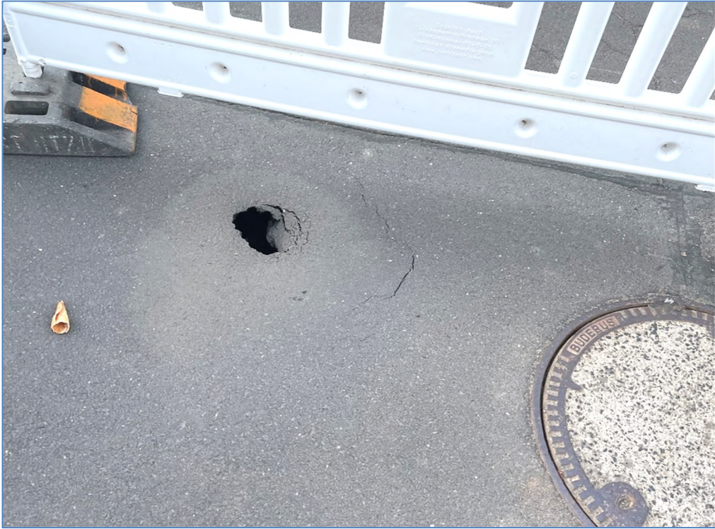
Bild oben: Kleines Loch große Wirkung; Deckeneinsturz in der Schwimmbadstraße der Kernstadt Lollar
