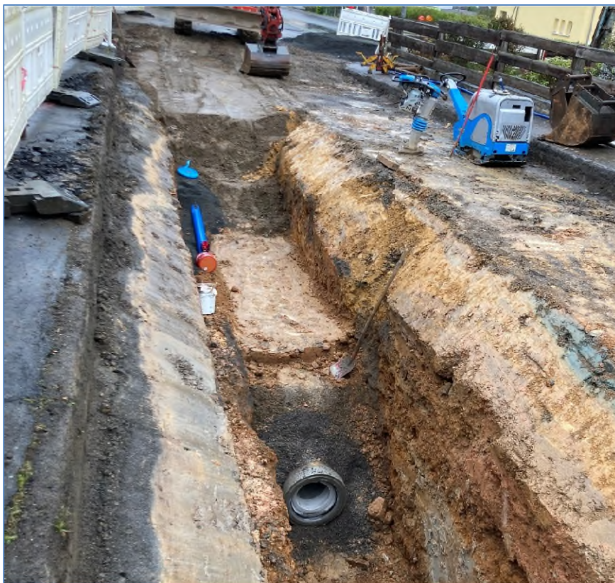
Erneuerung der Wasserleitung in der Blackenstraße in Lollar Herstellung Stufengraben für Wasser und Kanal
