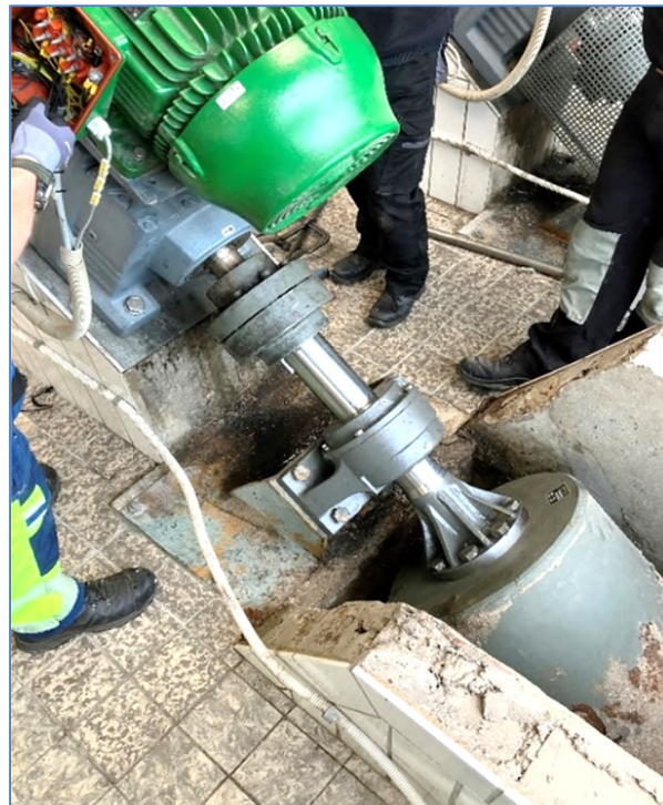
Blick auf das neue obere Lager - Förderschnecke KA Lollar
