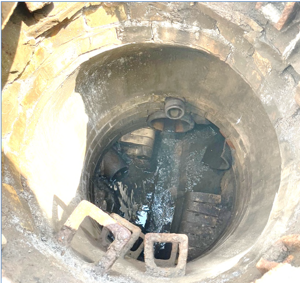
Bild unten: Blick in das schadhafte Schachtunterteil mi 4 Zuläufen
